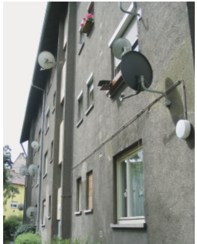
Überalterte Bausubstanz aus den 50er Jahren
