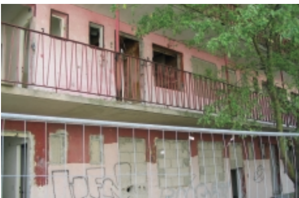
... und verfallene Gebäude
