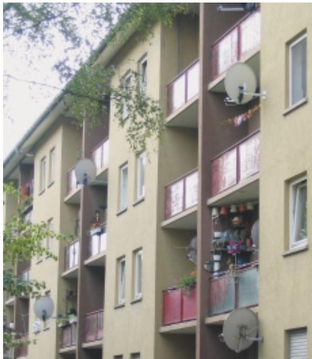
Gebäude mit Modernisierungsbedarf
