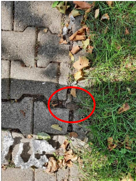
Abbildung 47: Wurzel drückt sich durch Pflasterbelag
