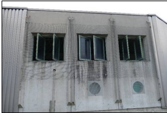
Abbildung 5: mit Netzen verschlossene Fensteröffnungen
