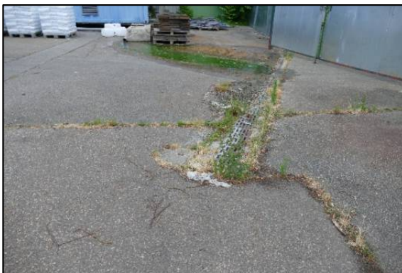
Abbildung 10: Risse im Asphalt mit Grasaufwuchs
