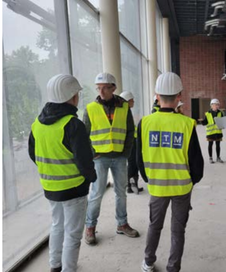
Baustellenbegehung: Generalsanierung NTM im Rahmen von URBANER WANDEL in der Nachbarschaft von T 4 / T 5 / Nationaltheater Mannheim
