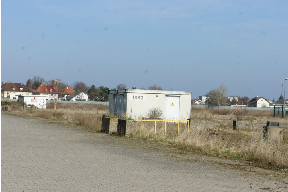
Foto Nr. 41: KVF 85; Trafostation Gebäude 1860
