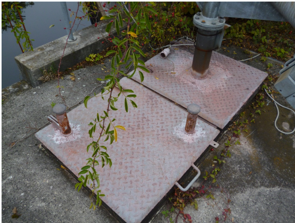
Foto Nr. 25: KVF 69; Altöltank östl. Gebäude 1701
