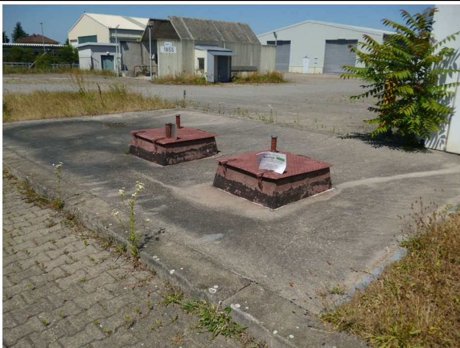
Foto Nr. 40: KVF 84; Frostschutzmittel- und Altöltank Gebäude 1852
