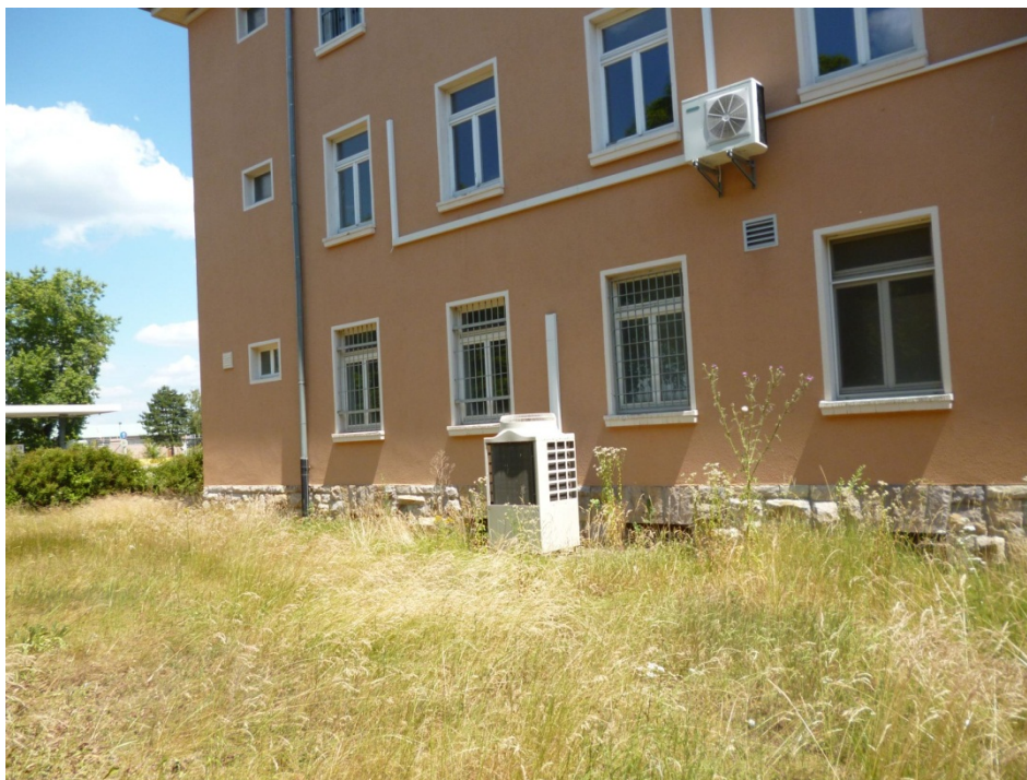
Foto Nr. 6: KVF 50; Kältemittelanlage nordwestl. Gebäude 1566
