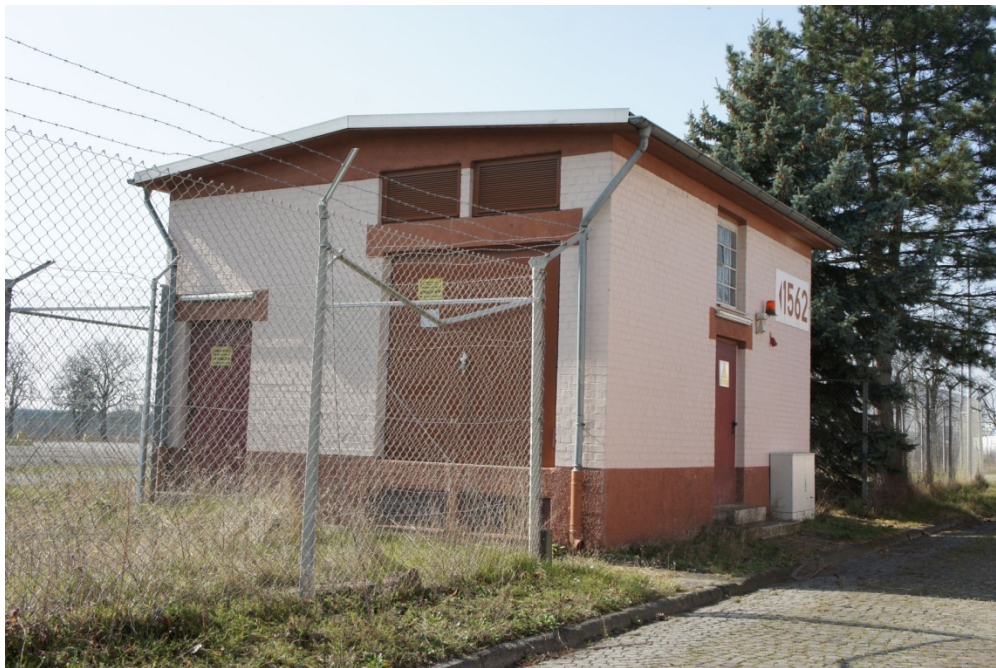
Foto Nr. 2: KVF 46; Trafostation Gebäude 1562
