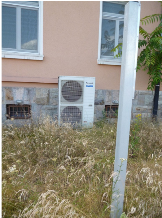
Foto Nr. 9: KVF 53; Kältemittelanlage östl. Gebäude 1566
