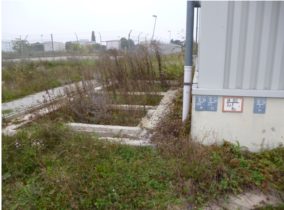
Foto Nr. 31: KVF 75; Heizöltanks Gebäude 1854
