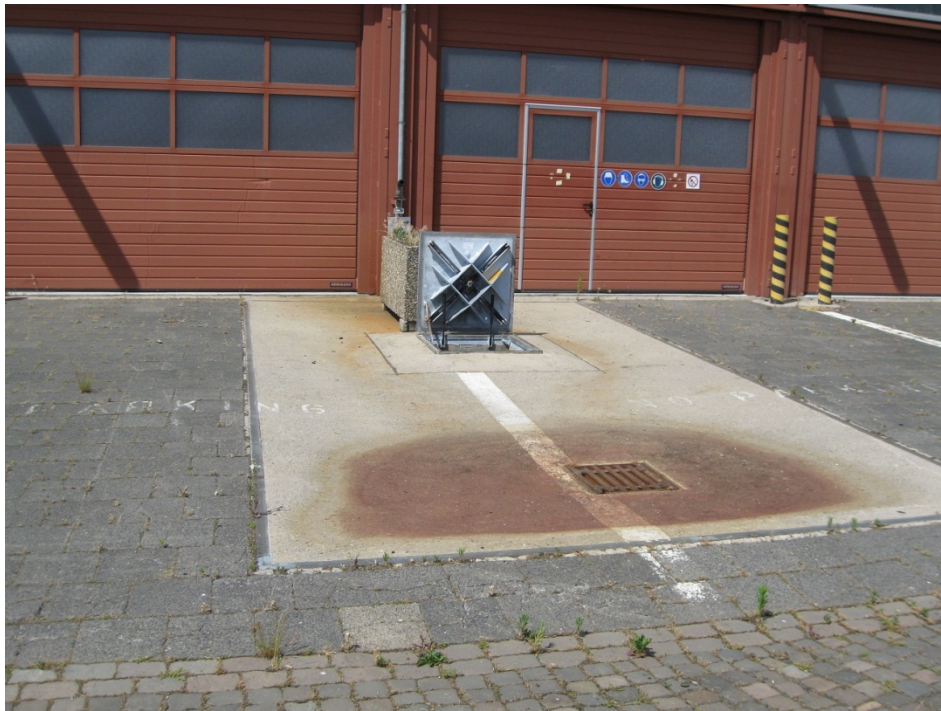
Foto Nr. 40: KVF 40; Altöltank südl. Gebäude1563
