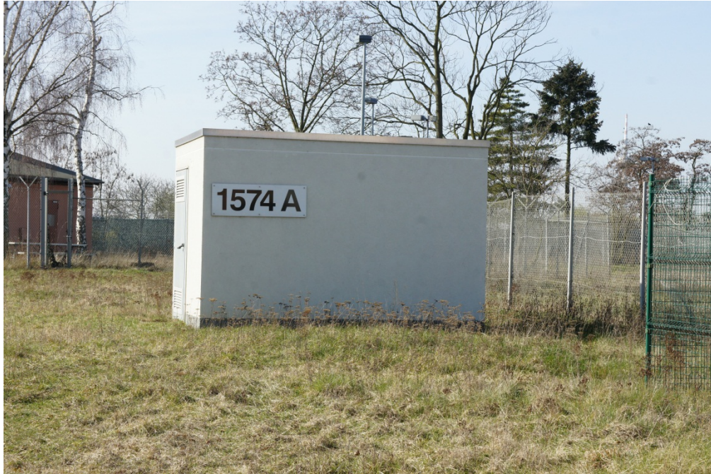
Foto Nr. 13: KVF 13; Trafostation Gebäude 1574A
