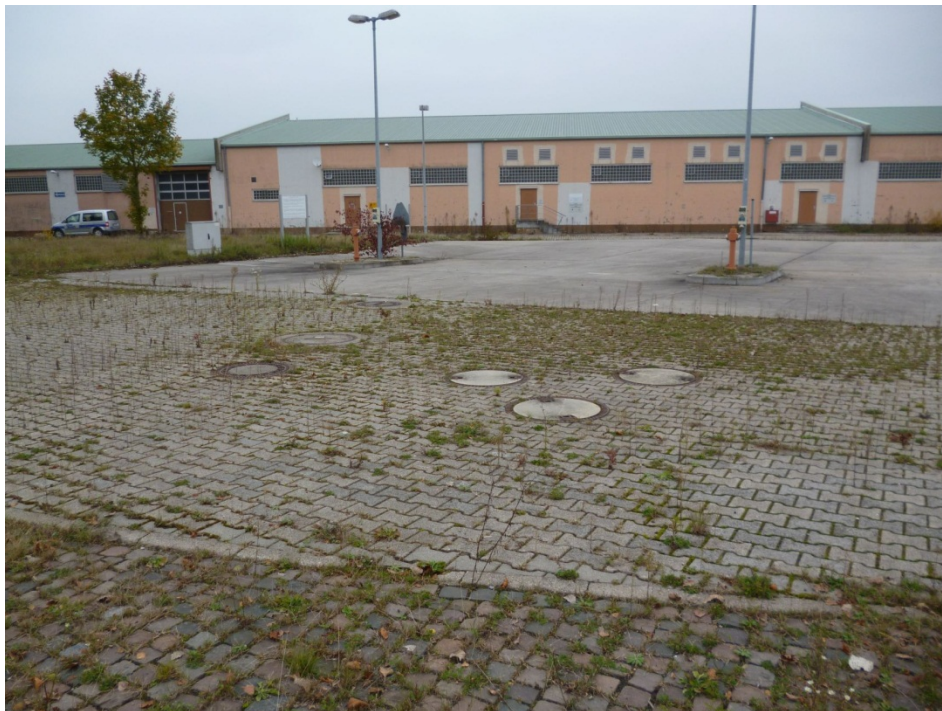
Foto Nr. 33: KVF 33; Leichtflüssigkeitsabscheider (5x) östl. Gebäude 1563
