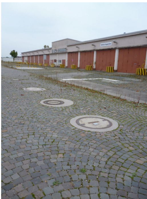
Foto Nr. 38: KVF 38 Leichtflüssigkeitsabscheider (3x) nördl. Gebäude 1567
