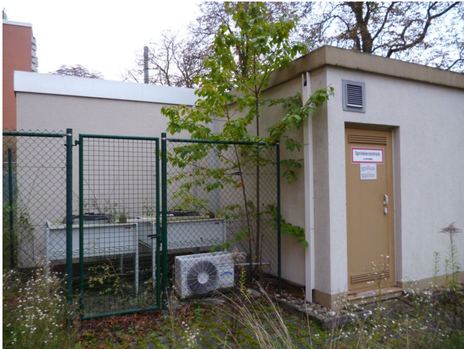
Foto Nr. 11: KVF 11; Kältemittelanlagen Gebäude 1583
