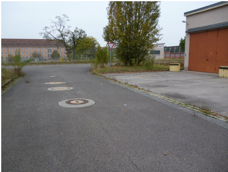
Foto Nr. 27: KVF 27; Leichtflüssigkeitsabscheider (3x) nördl. Gebäude 1571
