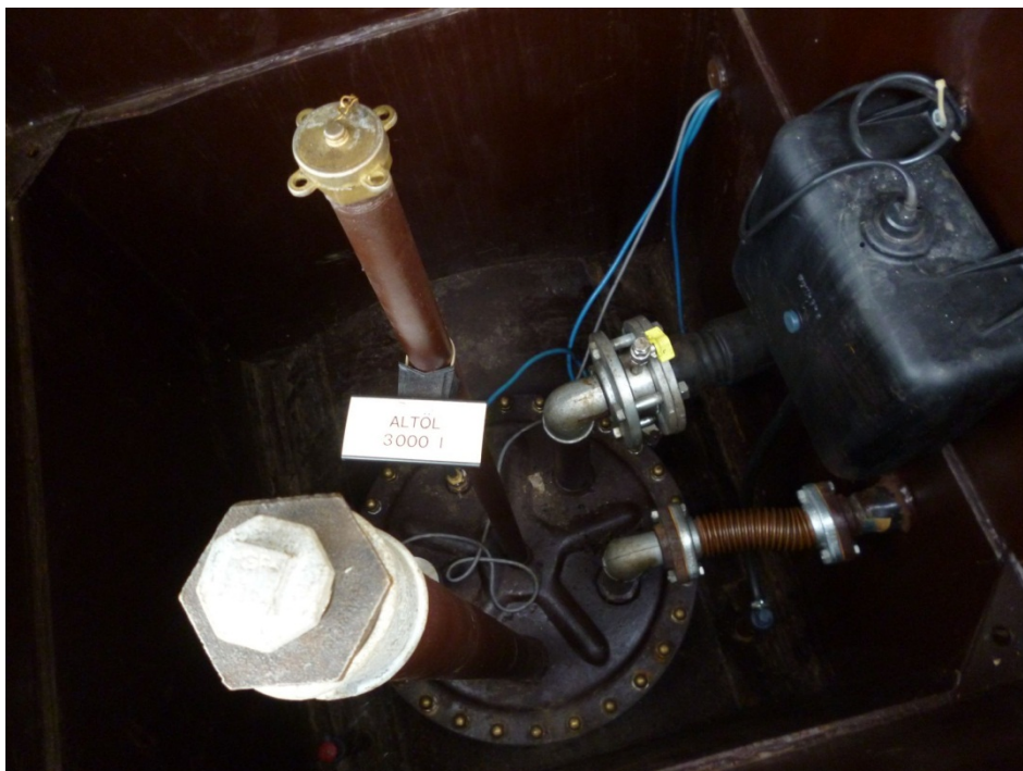
Foto Nr. 20: KVF 20; Altöltank 1/ Frostschutzmitteltank Gebäude 1577
