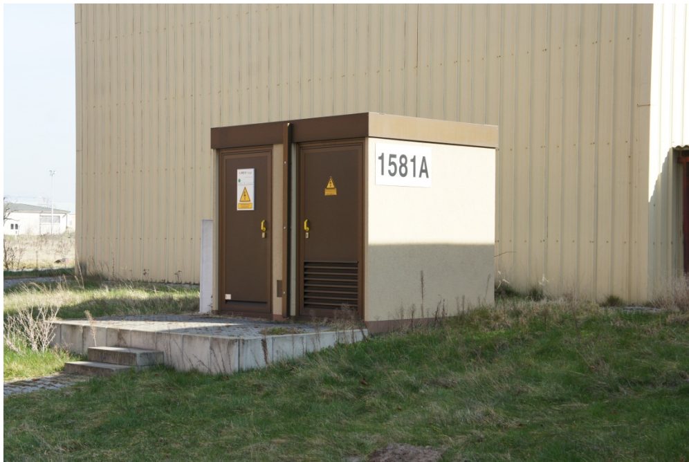
Foto Nr. 14: KVF 14; Trafostation, Gebäude 1581A
