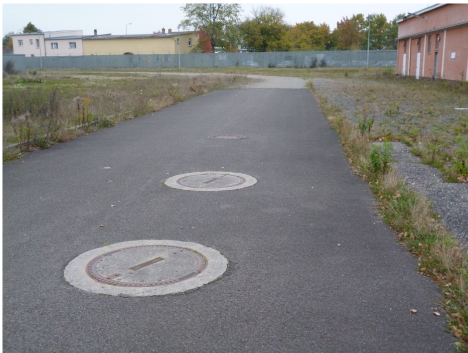
Foto Nr. 18: KVF 18; Leichtflüssigkeitsabscheider (2x) nördl. Gebäude 1582
