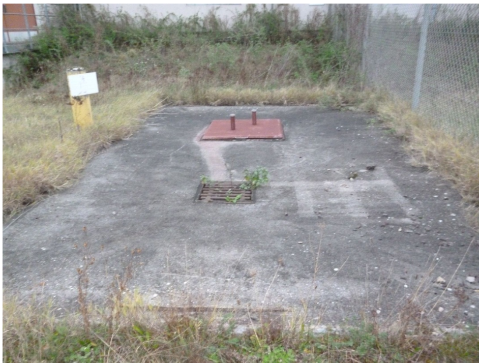
Foto Nr. 36: KVF 36; Altöltank südl. Gebäude 1567
